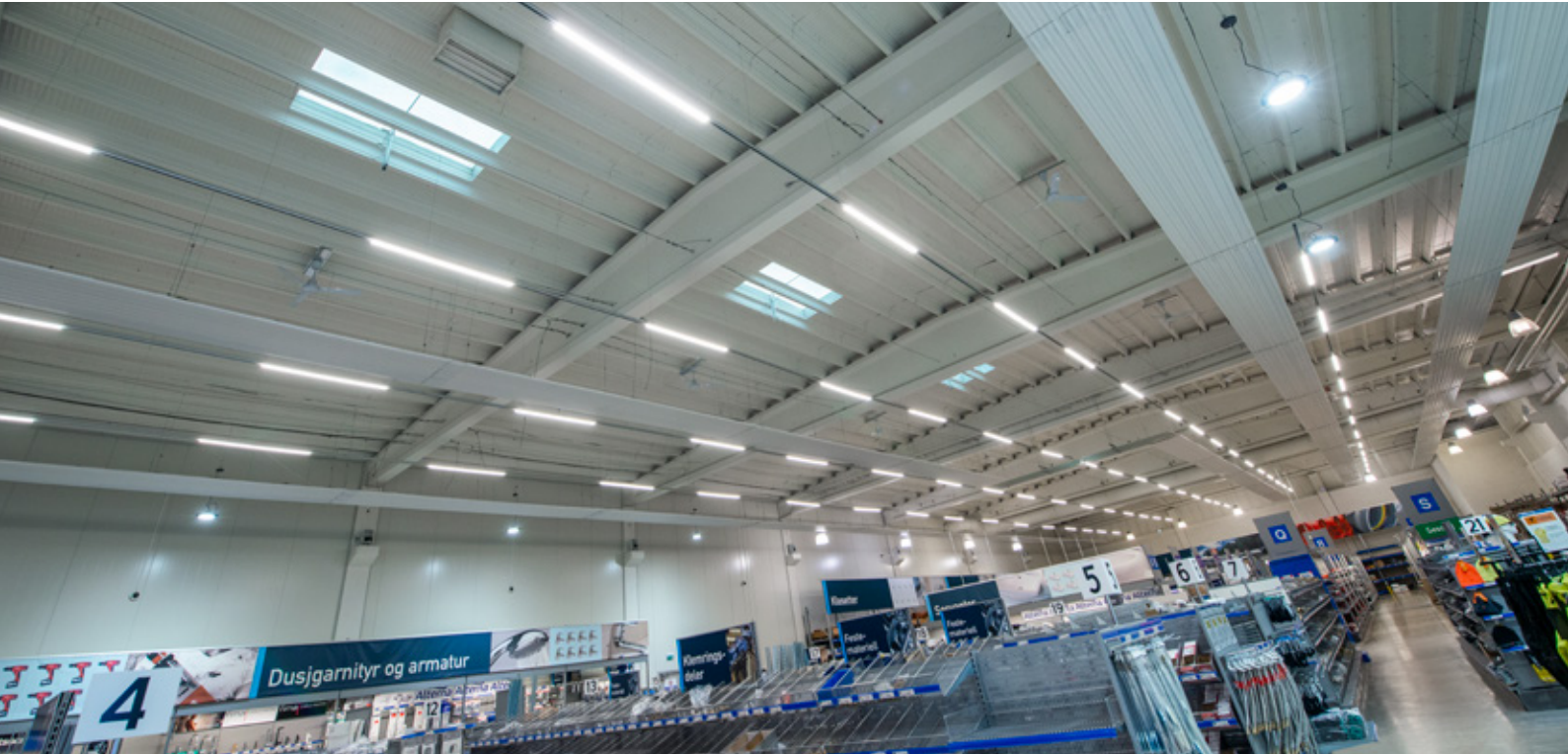
Skiftet til LED er et viktig energitiltak.
